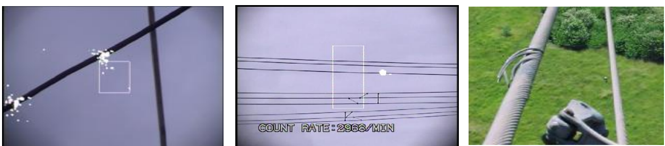
Рис. 8. Коронный разряд на повреждениях элементарных проводников ошиновки ОРУ 220 кВ (слева) и вид повреждений высоковольтной линии (справа)
