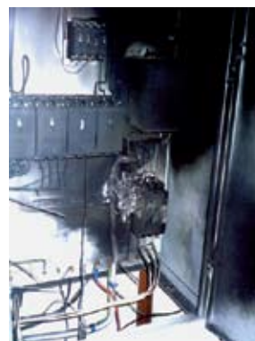
Рис. 16. Выход из строя УЗИП на основе варистора привел к пожару в ГРЩ
